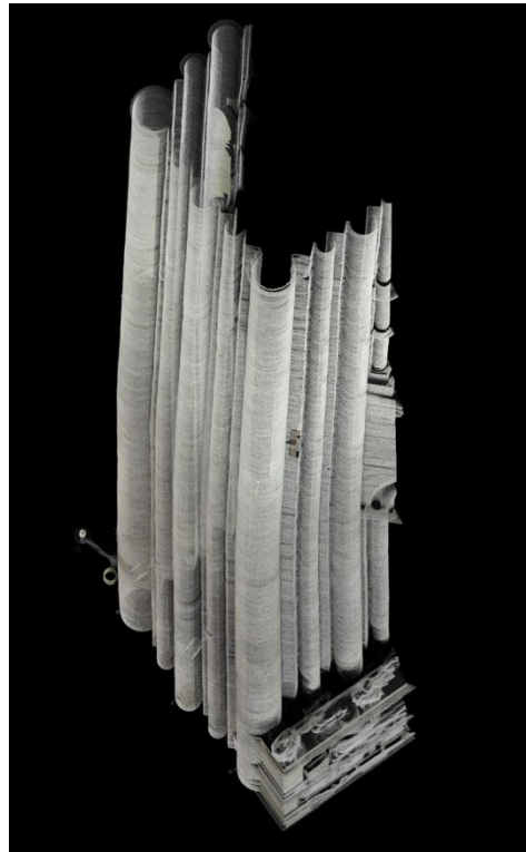
Figure 2 : Déviation du pilier nord-ouest de la croisée du transept. Les déformations sont dues à des poussées non contrebutées.
